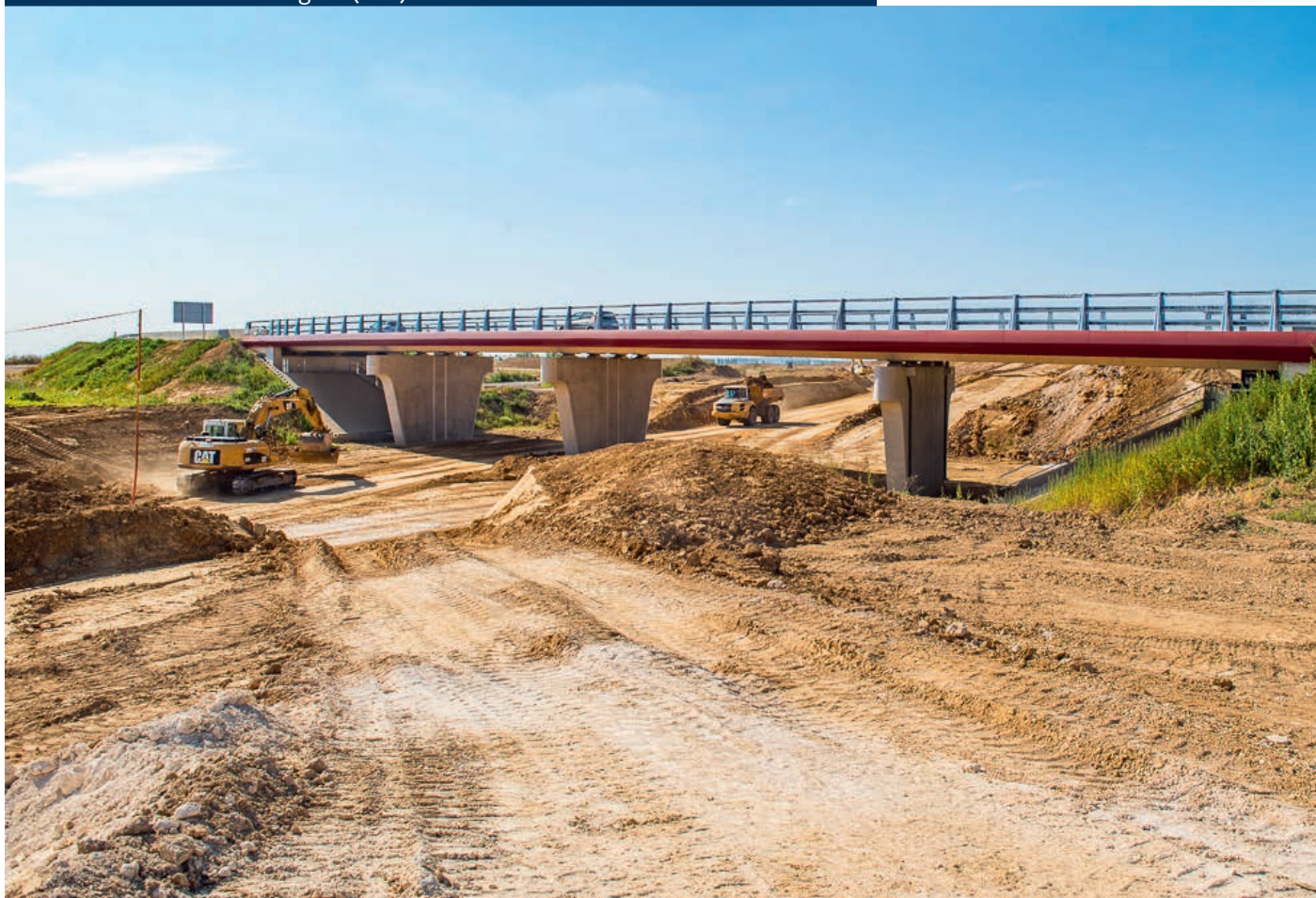
Août 2021 - Pont de Mauregard (PS9) achevé et terrassements de la future A104
