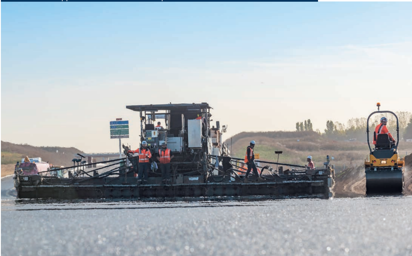
Octobre 2022 - Application des enrobés sur la phase 2 du CER entre le Mesnil-Amelot et l'A1
