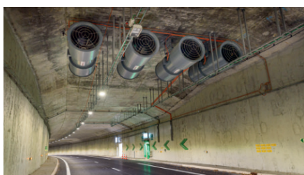
Système de ventilation installé dans les tunnels (tunnel de Boissy)
